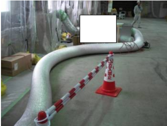
<負圧除塵装置設置状況>
